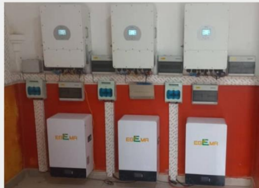
Badalabougou (Bureau) 24kW - 30kWh
