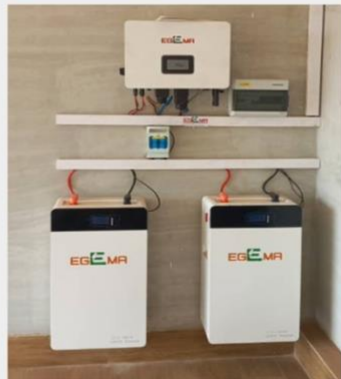
Magnambougou (Domicile) 8kW - 30kWh
